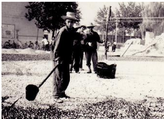
河北省公路工程队一工区在津保公路进行石油沥青路面试铺(1958)
