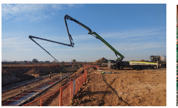
近日，第六公司安徽G329项目K4+389钢筋混凝土盖板涵正在进行基础浇筑施工。在施工过程中，项目部严把安全关与质量关，以规范性流程，标准化作业稳步推进施工进度。(冯程)
